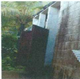
Foto 3: La foto evidencia la necesidad del cambio de puertas de los baños.
