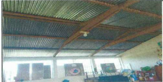
Foto 2: La foto evidencia el cambio de estructura de mader por metal.
