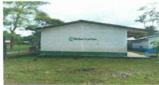
Foto 4: La foto evidencia la necesidad de cambiar la pintura en interiores y exteriores.
